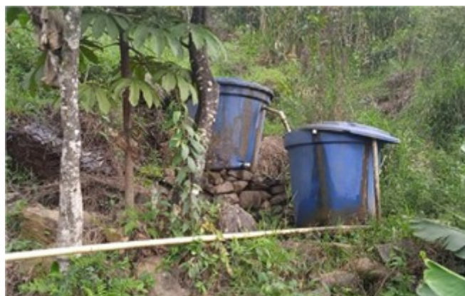
IMAGEN 24 Tanques de agua, acueducto El Pacífico Archivo comunitario
